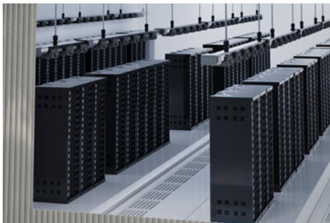
Anwendungsbereiche im Rechenzentrum
