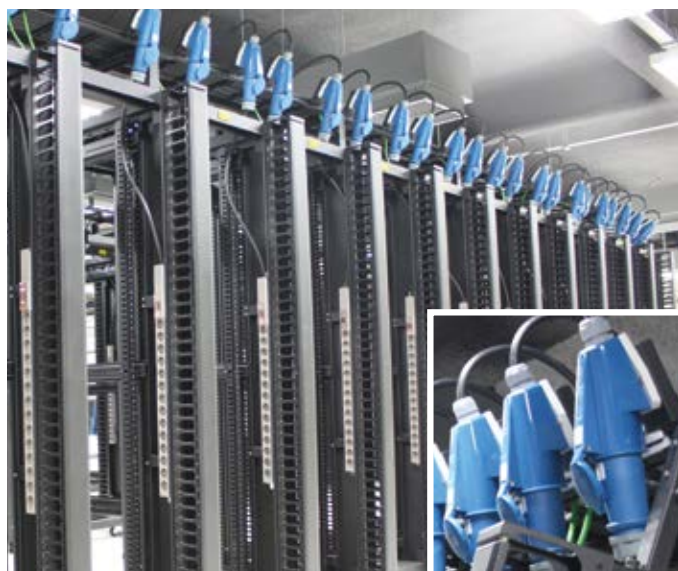
Internet Data Center , Korea Południowa
